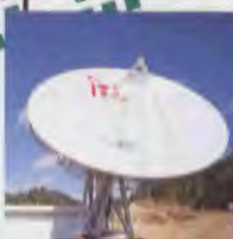
ITJ 千葉衛星通信局 ITJ Chiba Satellite Earth Station
